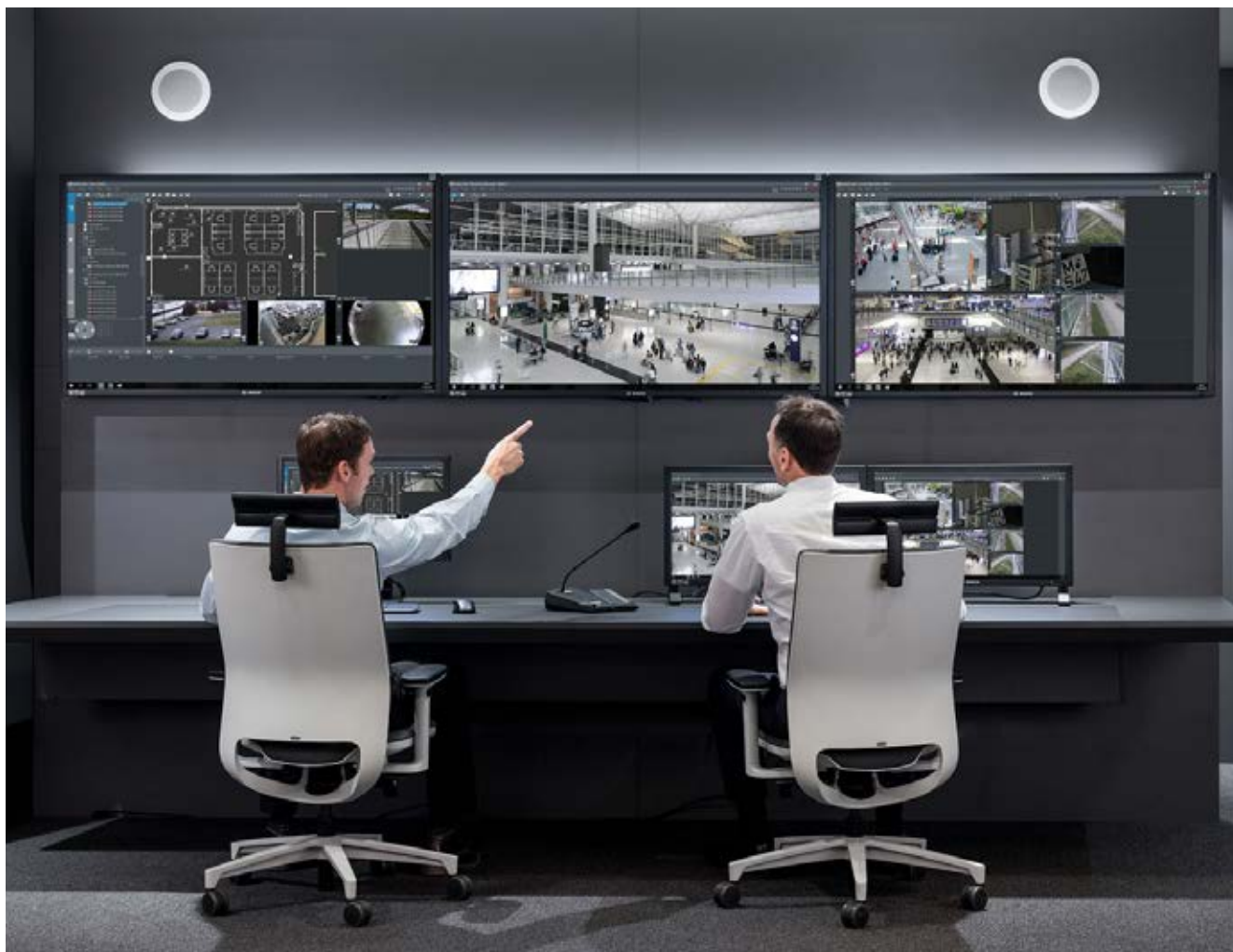
Dohledové centrum ostražky objektu.
